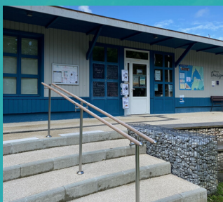
UNE MAIN COURANTE AU MILIEU DE L'ESCALIER PRINCIPAL
